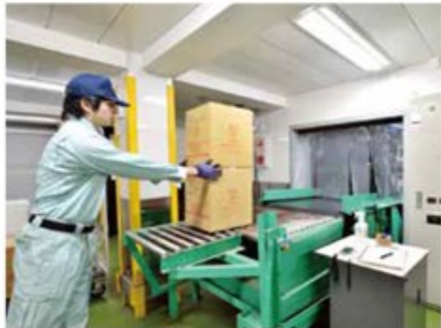
容器に入った廃棄物はバーコードチェックされた後、重さを自動的に計量され、投入コンベアにより焼却炉へ搬送される
