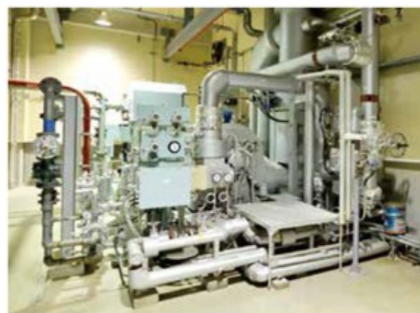
高温の焼却熱を利用して、ボイラーで発生した蒸気を送り込みタービンを回し発電を行うサマル発電設備
